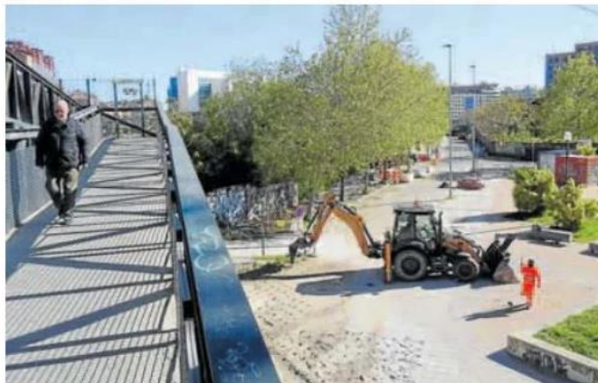
La pasarela hacia La Farola, con la máquina picando la solera aldeaña mientras se completa el tramo de acera hasta el paso a nivel. J. SANZ
